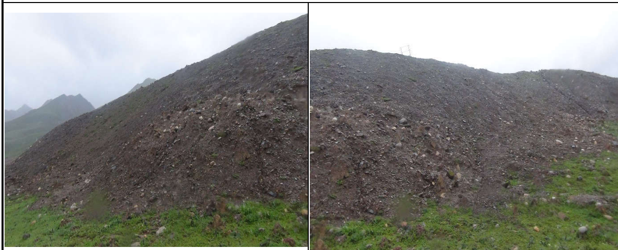
K1694+000 路右 50m 弃渣场，渣场坡度较陡，建议对渣场进行分级防护，及时修建浆砌石挡土墙，覆土以撒播草籽绿化。
