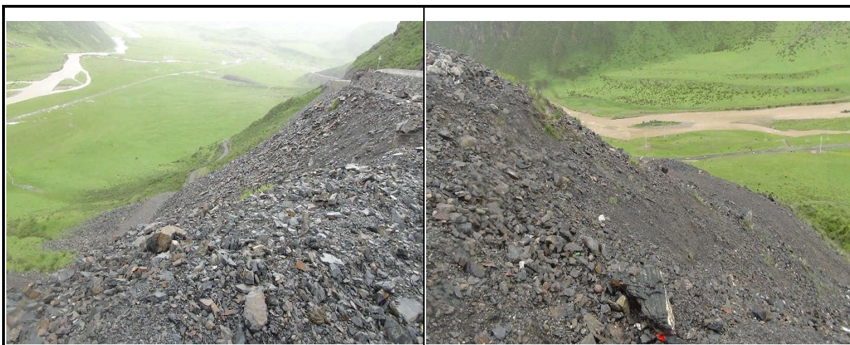
K1675+950 左侧 20m 弃渣场，渣场坡度较陡，建议对渣场进行分级防护，及时修建浆砌石挡土墙，覆土以撒播草籽绿化。
