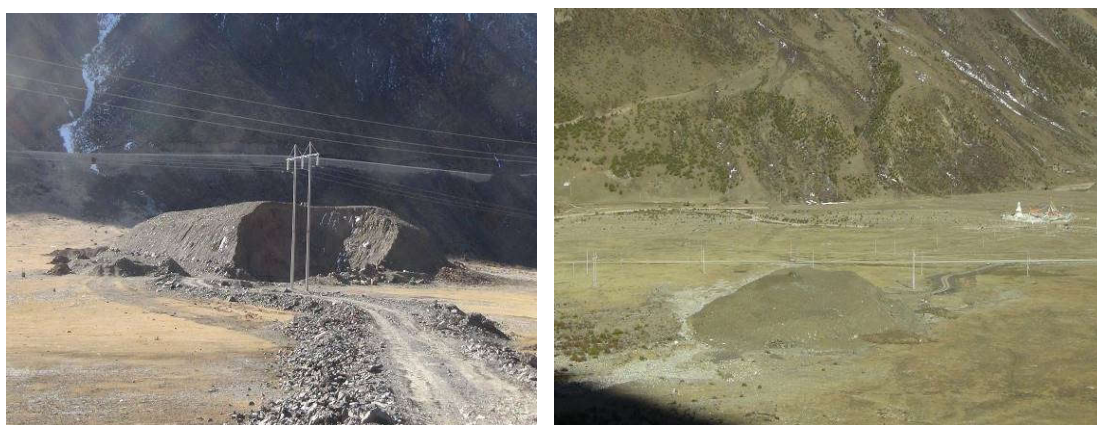
K1678+000 左侧 50m 弃土场干砌石挡土墙已经被当地拆掉，建议修建浆砌石挡土墙及排水沟，边坡及弃土场顶部覆土以撒播草籽绿化。
