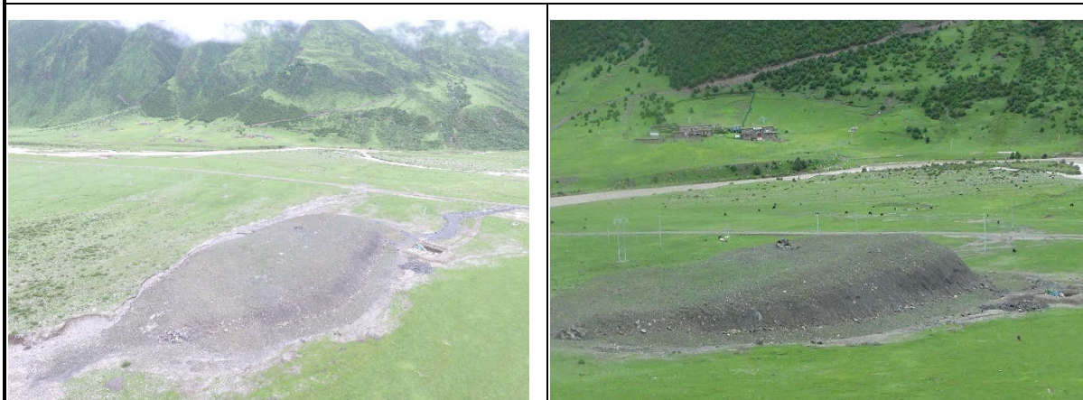
K1678+000 左侧 50m 弃土场干砌石挡土墙已经被当地拆掉，建议修建浆砌石挡土墙及排水沟，边坡及弃土场顶部覆土以撒播草籽绿化。
