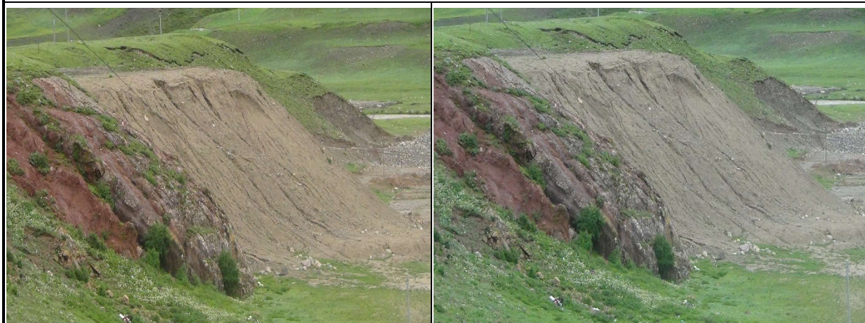
K1723+200 路左 80m 渣场，渣场坡度较陡，建议对渣场进行分级防护，及时修建浆砌石挡土墙，覆土以撒播草籽绿化。
