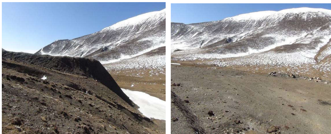
K1669+405 弃渣场，及时在渣场下边坡修建挡土墙，并在渣场顶部撒播草籽绿化。
